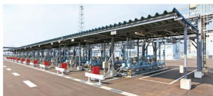
ひびきLNG基地 出荷設備
