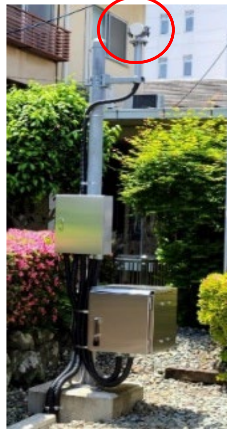
地上無線機アンテナ（赤丸部）
