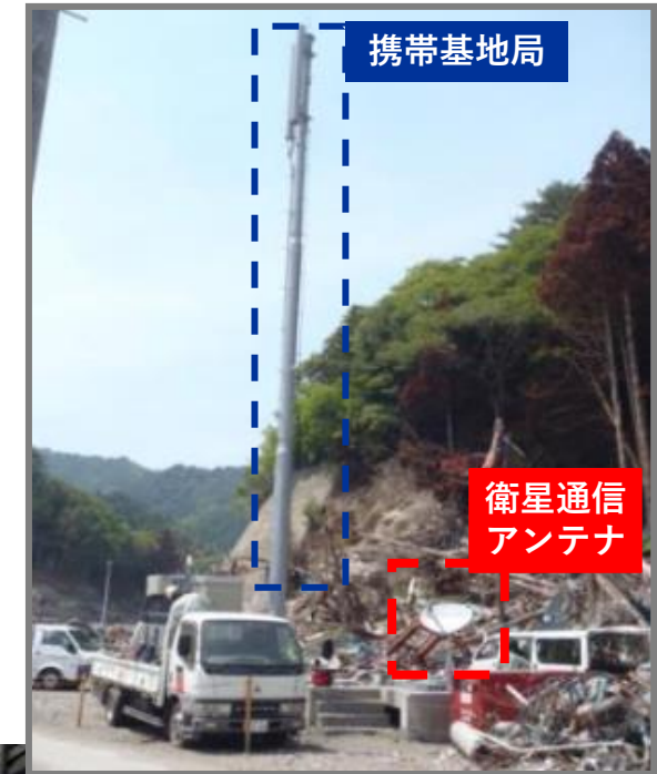
災害現場の携帯移動基地局
